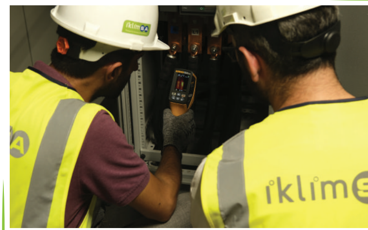
Termal Kamera ile Bağlantı Kontrolleri
